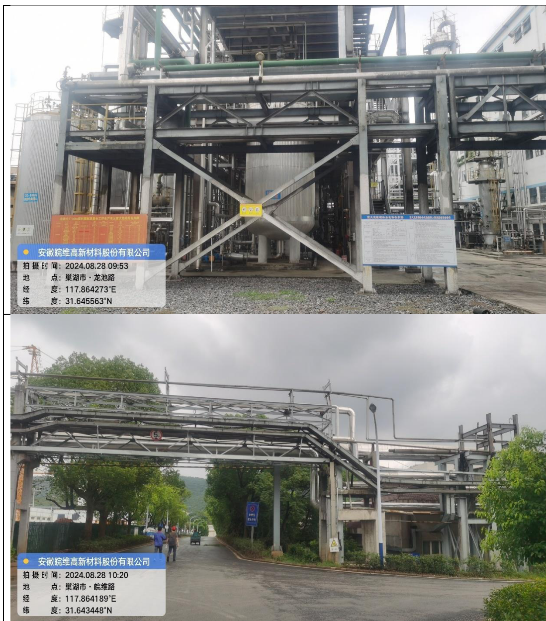
图 4.1-5 部分地上管道现状图
